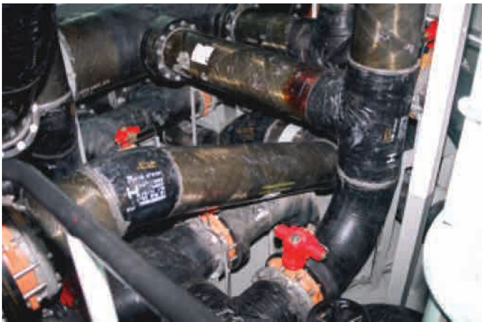
Tubulatură Ameron în C.P.
